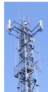
Estación Base de GSM
